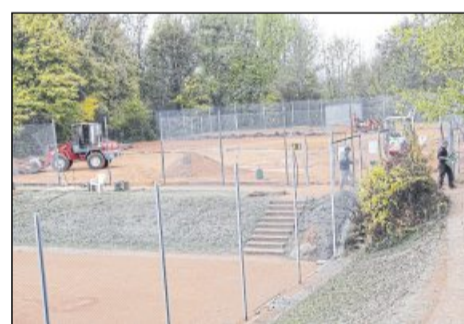
Erste Sanierungsmaßnahme nach 50 Jahren: Die Plätze 1 und 2 bekommen gerade eine neue Bewässerungsanlage und eine neue Drainage.
